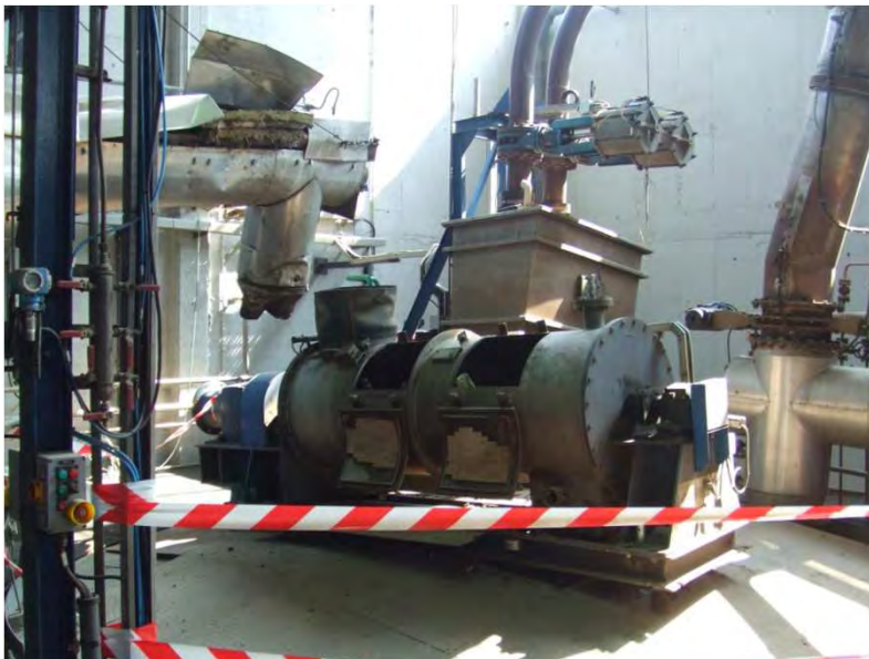
Explosión planta tratamiento de Fangos
